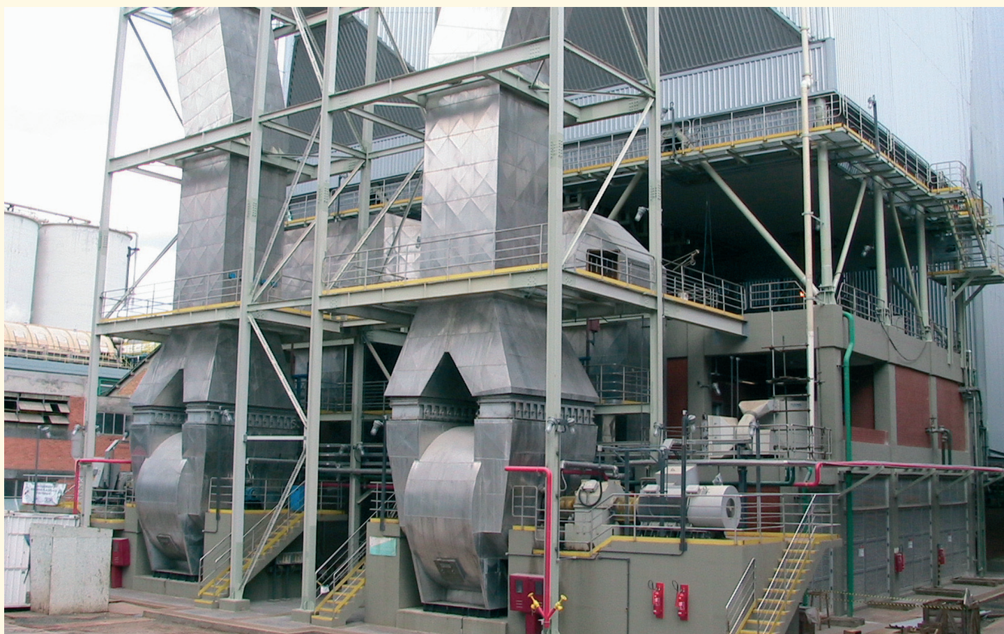
2x34 KSL, 2000 кВт - 1200 об/мин. Привод вентилятора (Бразилия)
